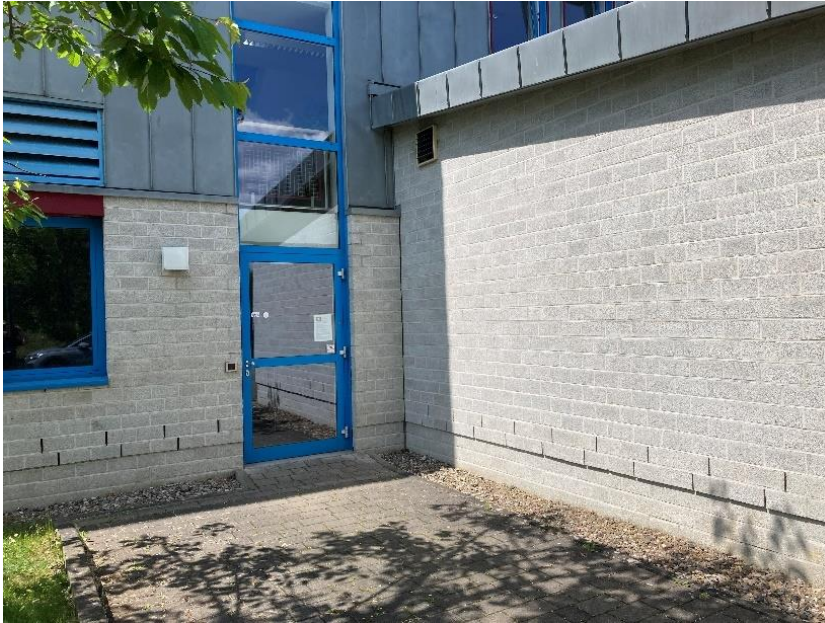
Abbildung 3 Abluftventilator des Kältemaschinenraumes unterhalb der Dachkante, links im Bild die Zuluft der Lüftungsanlage 8
